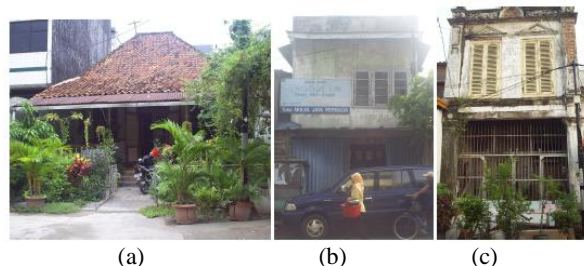
Gambar 18. Bangunan kuno yang mengalami kerusakan
